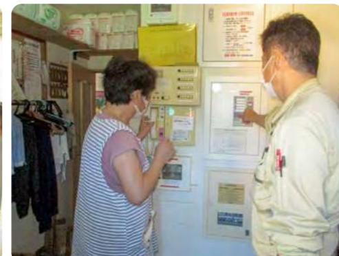
「この通報装置で火元感知、煙感知を確認し、次の行動へ移ってください」レクチャーする保守管理会社「消防機材」の八木橋所長
