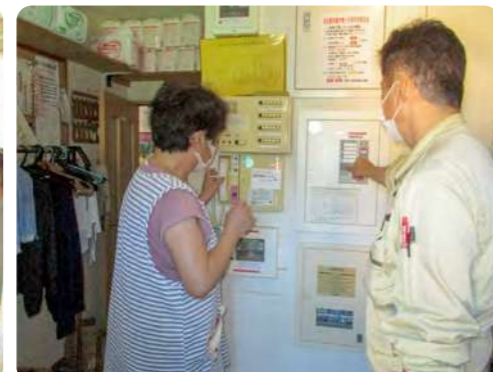
「この通報装置で火元感知、煙感知を確認し、次の行動へ移ってください」レクチャーする保守管理会社「消防機材」の八木橋所長
